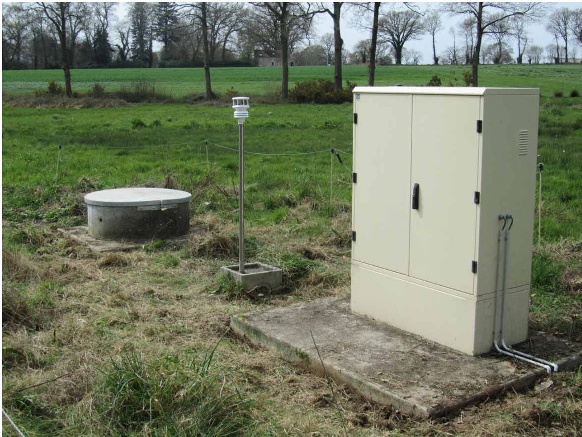
FIGURE 1 – Vue de la station BEGF le 23 mars 2022.
